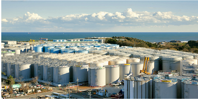
Cuves de stockage des eaux contaminées sur le site de la centrale de Fukushima Daiichi, d'une capacité de 1,37 millions de tonnes.
